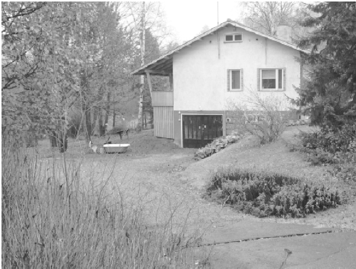
Unelmien talo odottaa nuohoojan ja kuntokartoittajan suosittelemia korjauksia. Kuva: Jonni Roos.
