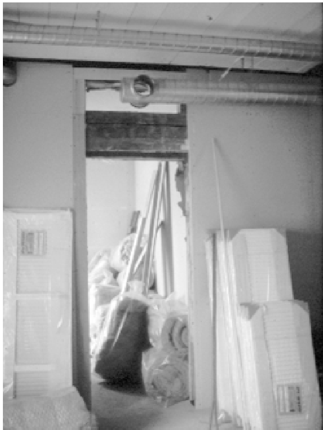
Sähkövetojen piilottaminen ajaa seinien tarpeettomaan levyttämiseen ja ilmanvaihto vaatii alas lasketun katon. Vanhat pinnat pitäisi jättää alle koskemattomina tapetteineen maaleineen, niin että tuleva taitavampi korjaaja saa ilon löytää ne jälleen. Kuva: Panu Kaila.
